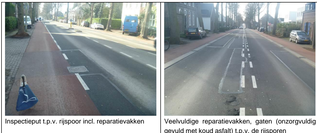
Figuur 7 Voorbeelden van schades op de Tongerseweg – sub-vak 2 t/m 5
