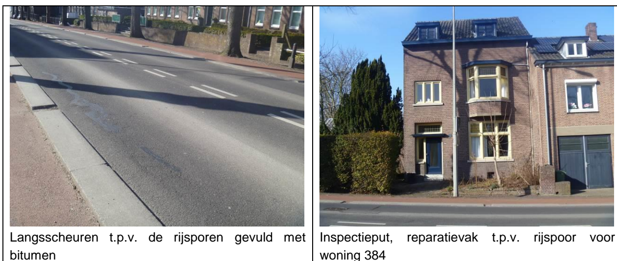
Figuur 8 Voorbeelden van schades op de Tongerseweg – sub-vak 2 t/m 5
